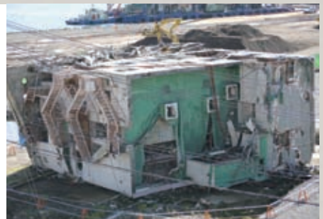
土台から倒されたビル。手前(緑部分)が屋上
